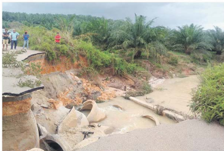
Runtuhan tanah membabitkan kawasan pembentung di jalan raya berkenaan.
